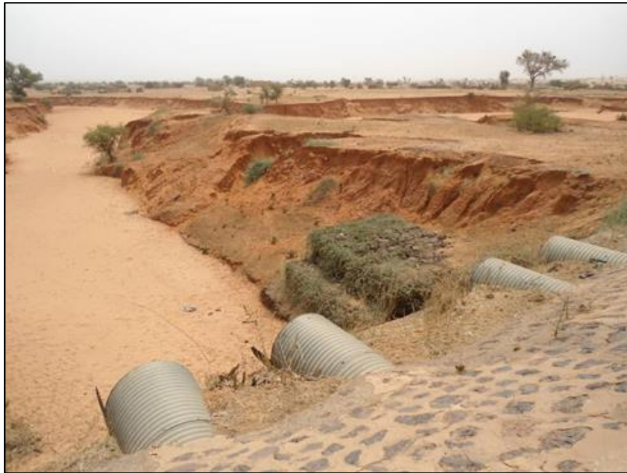
Figure 11. La rupture du pont de la RN 27 par le kori Damari en 2012
