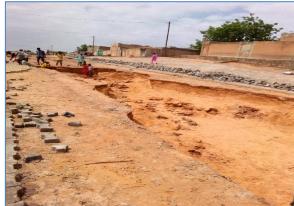
Figure 8. Nouveau pavé érodé
