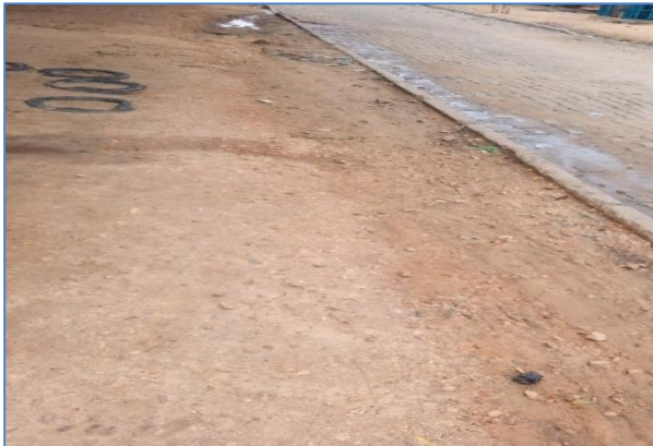
Figure 7. Érosion adjacente à la bordure
