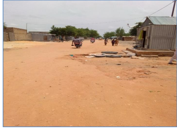
Figure 5. Latérite entamé par l'érosion
