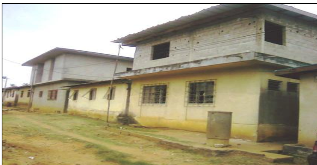
Figure 4. Tentative de construction de maisons en hauteur à Akouè-Santé (R. K. Oura, 2010, Août)
